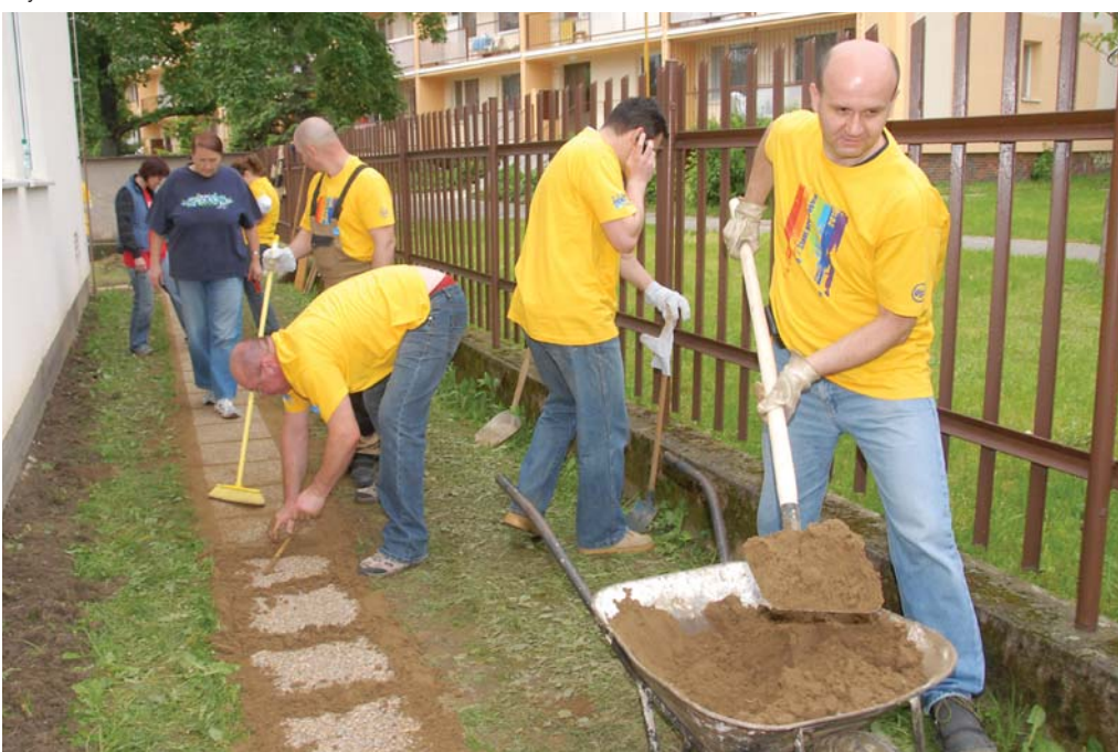
Domáci mali hádam najväčšiu radosť z tohto betónového chodníčka, ktorý uľahčí prístup detí do školy. Na jeho výstavbe s chuťou pracovali Vladimír Jacko, Radovan Kobularčík, Marián Fecko a Stanislav Lucík.
