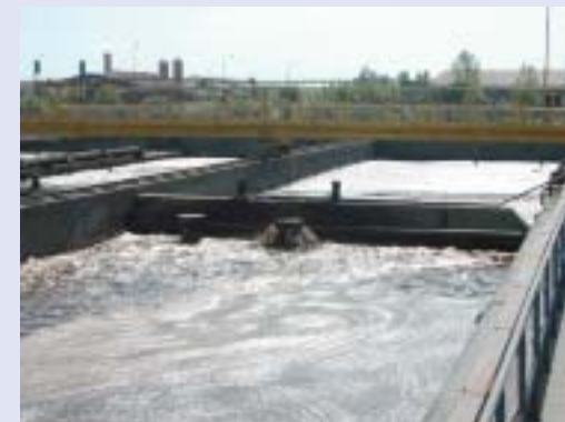
Biologická čistiareň odpadových vôd Biological Waste Water Treatment Plant
