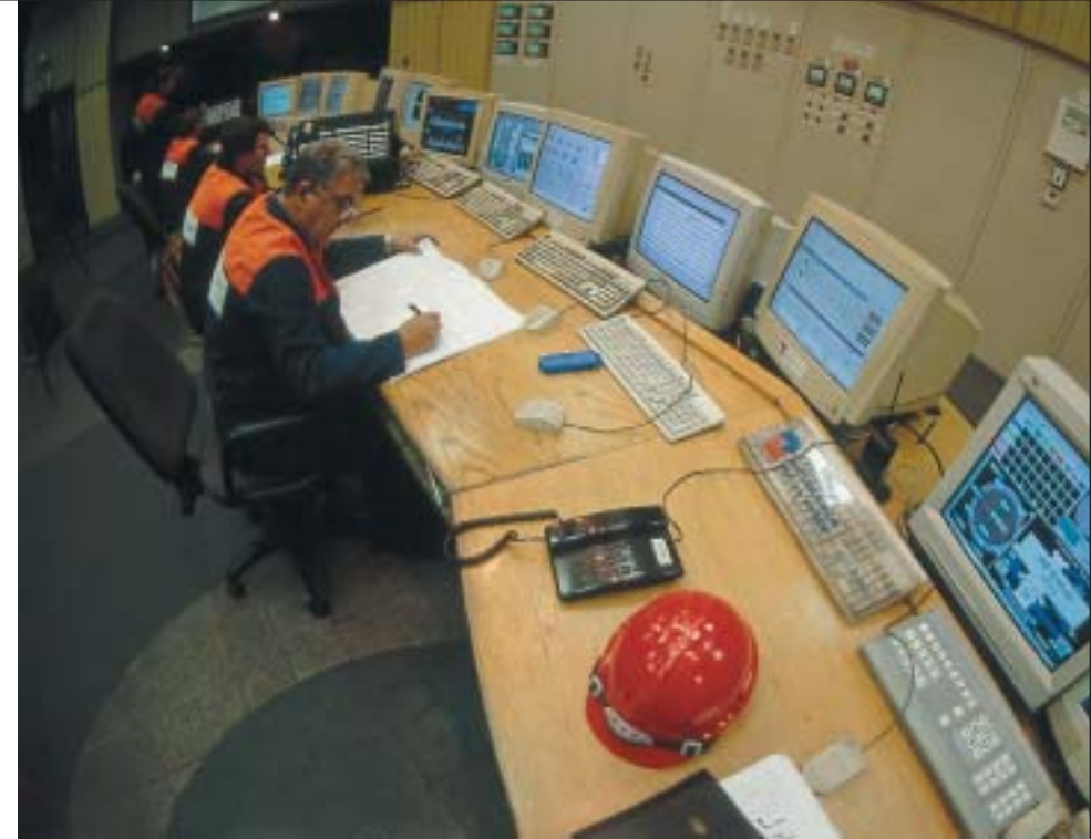
Riadiace centrum vysokej pece č. 3 Blast Furnace #3 Control Room
